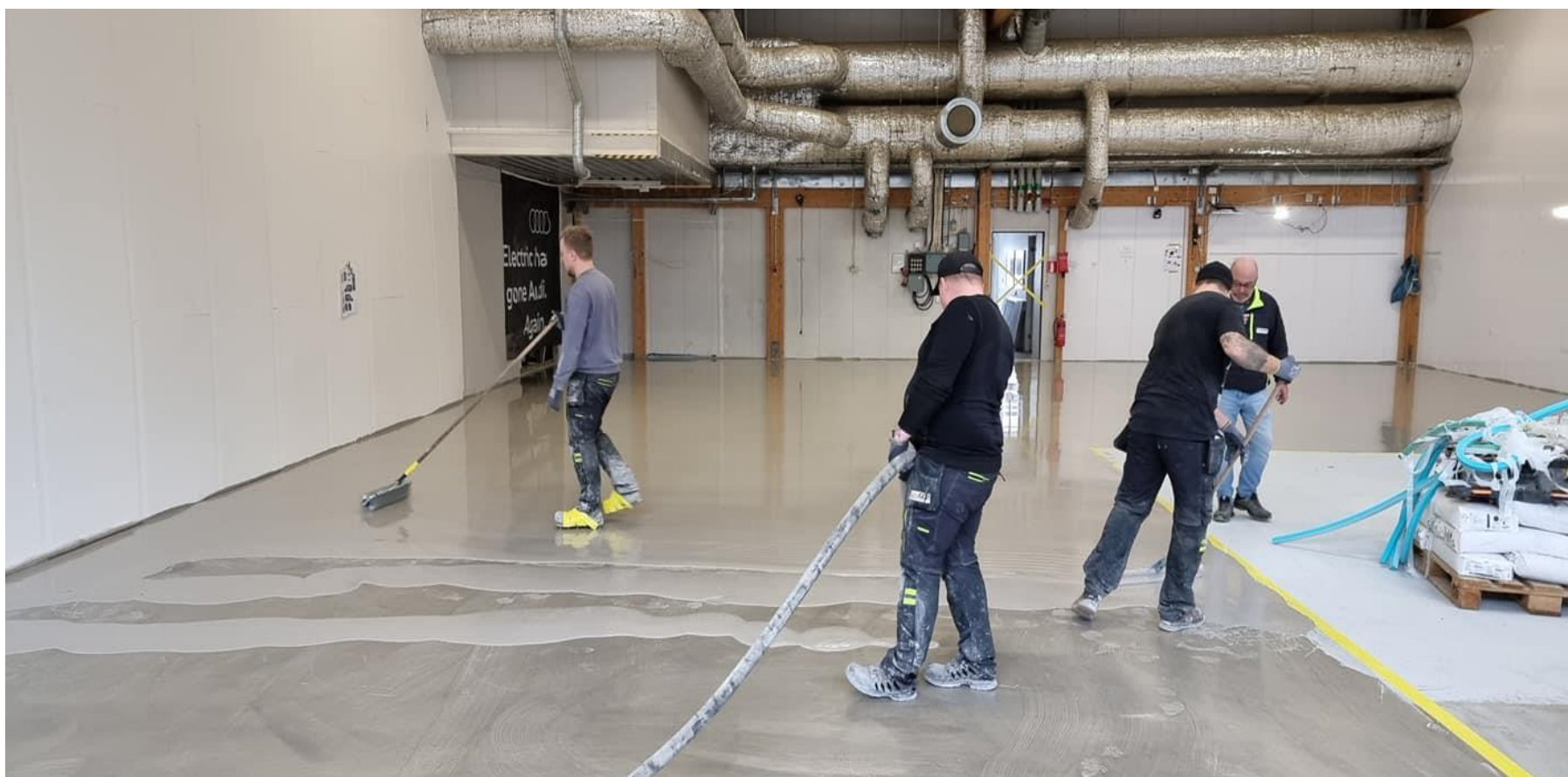
HALA SERWISOWA SALON AUDI W SYSTEMIE ECO SILICATE: ECO PRIMER + ECO RAPID SL + ECO HYDRO SIL
